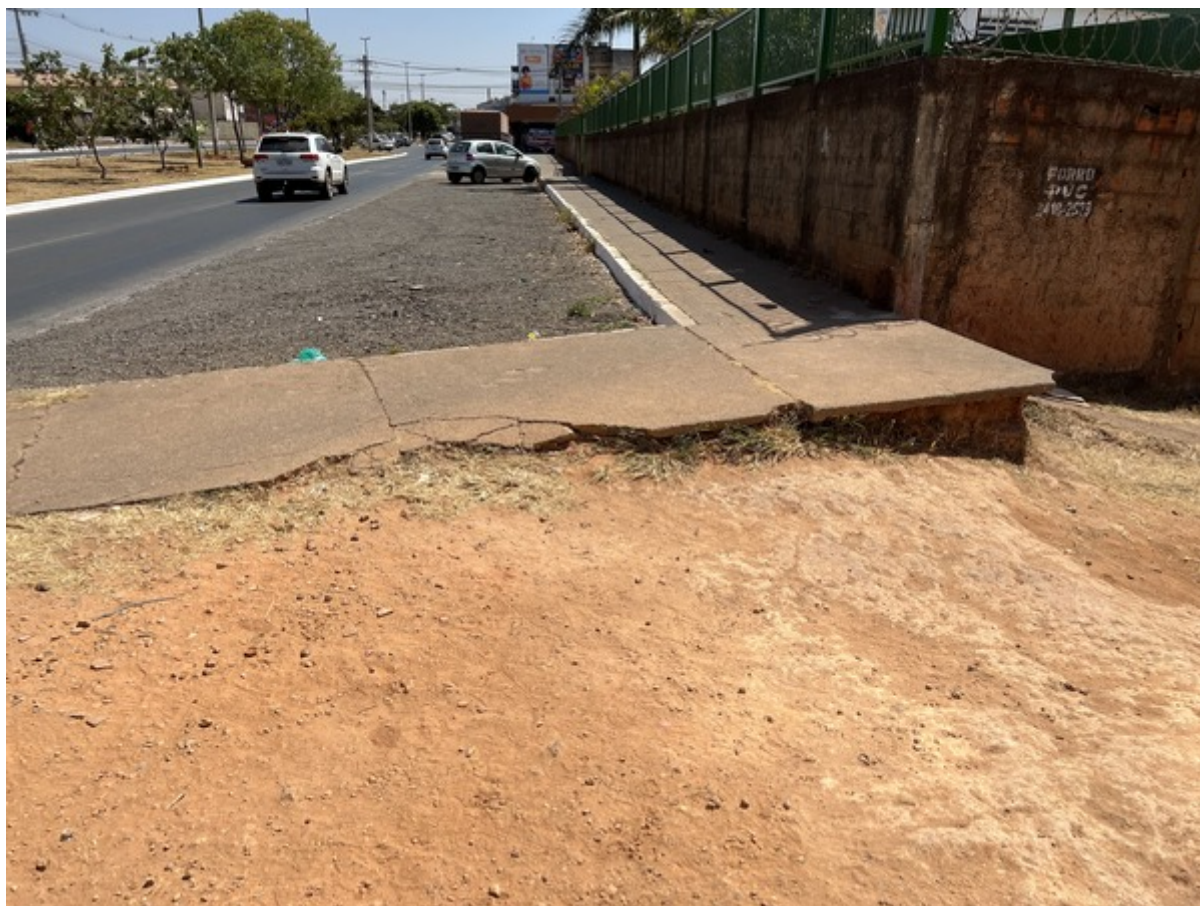
Figura 14 – Foto 4: detalhe calçada sem manutenção, desnível sem proteção
