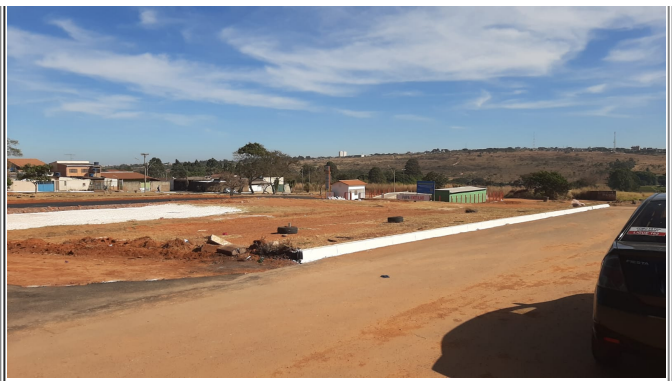
Figura 13 - Acesso viário executado sem diretriz de projeto e sem SIV aprovado.
