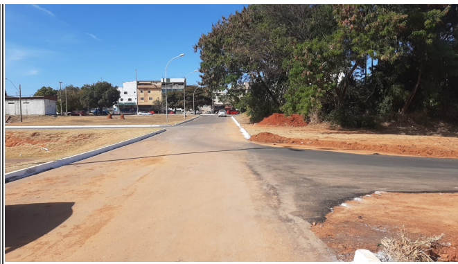
Figura 12 - Acesso viário executado sem diretriz de projeto e sem SIV aprovado.
