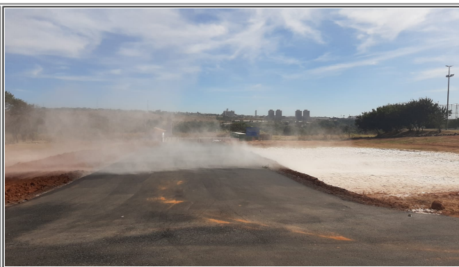
Figura 11 - Acesso viário executado sem diretriz de projeto e sem SIV aprovado.
