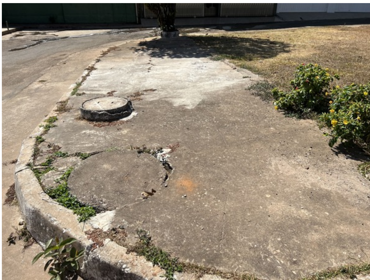
Figura 20 – Foto 10: detalhe calçada sem acessibilidade e degradada
