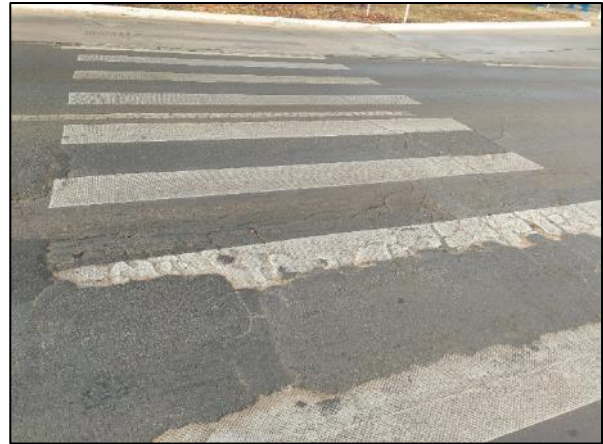
Foto 4.27: Presença de remendos e patologias, inclusive nas faixas de pedestre.
