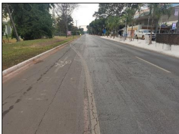
Foto 4.24: Degradação do pavimento nas faixas de rolagem, com afundamentos de roda, trincas e remendos também no acostamento em frente ao posto Melhor – sentido oeste (sentido Aeroporto).
