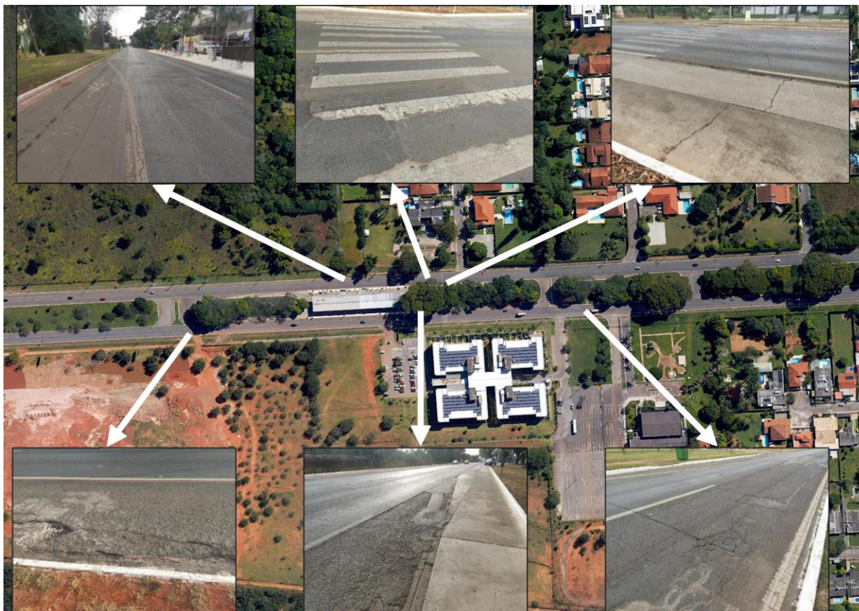
Foto 4.31: Localização em planta das principais patologias encontradas no inventário de pavimento realizado em campo.
