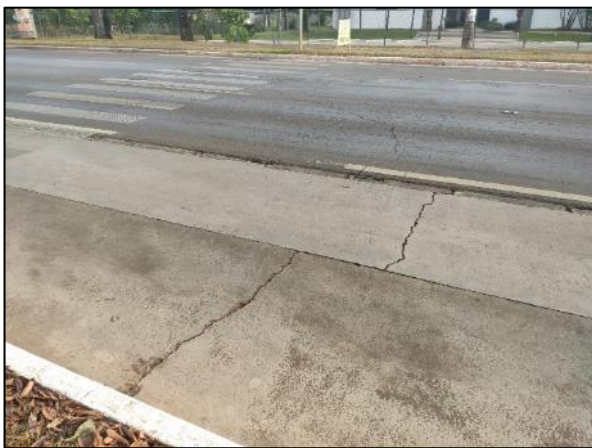
Foto 4.28: Presença de trincas ao longo de todo o pavimento.
