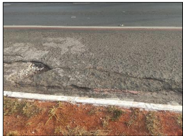
Foto 4.29: Presença de buracos nos acostamentos/ciclofaixas que geram insegurança para ciclistas e motoristas.
