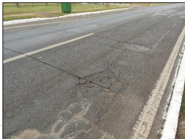
Foto 4.30: Laços indutivos não removidos e degradação por percolação de água.
