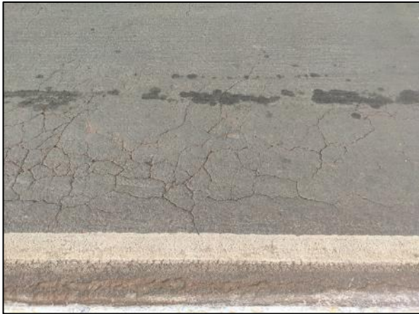
Foto 4.26: Presença de trincas que podem resultar no surgimento de buracos no pavimento.
