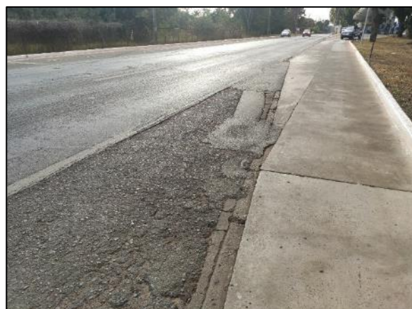
Foto 4.25: Patologias na interface da faixa de Aceleração do Posto Melhor.
