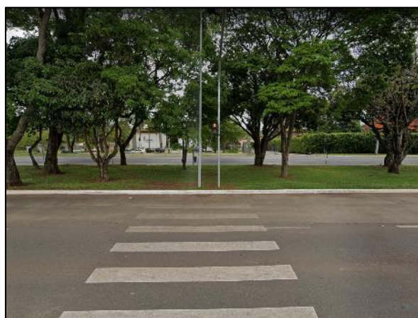
Foto 4.23: Travessia de pedestres sem calçamento no canteiro central.
