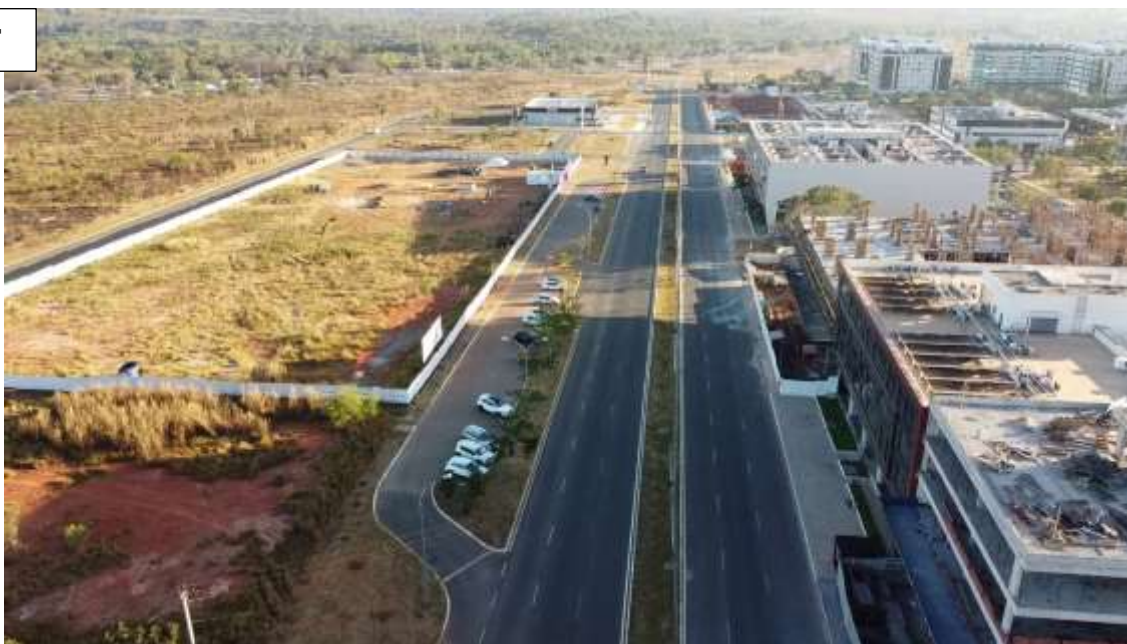
Figura 194 – Ilustração das obras ao longo da via W9, com previsão de aumento da rede de circulação.
