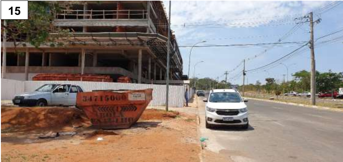
Figura 214 – Ponto 15 -Trechos sem calçada em áreas em obra nas proximidades do empreendimento.
