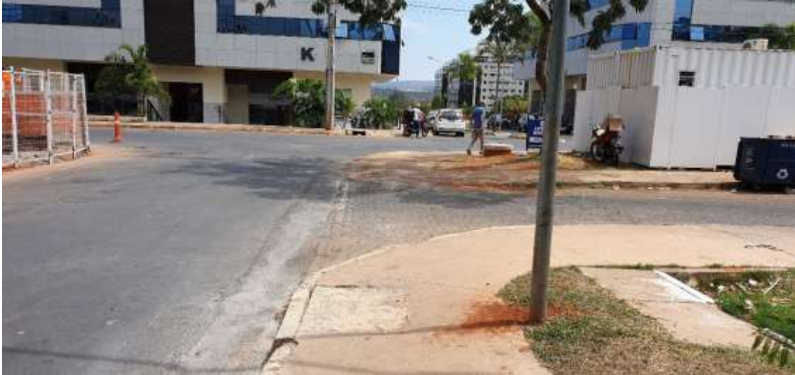
Figura 238 – Trechos de calçadas danificadas em áreas de obra entre as quadras CRNW 510 e SQNW 310.
