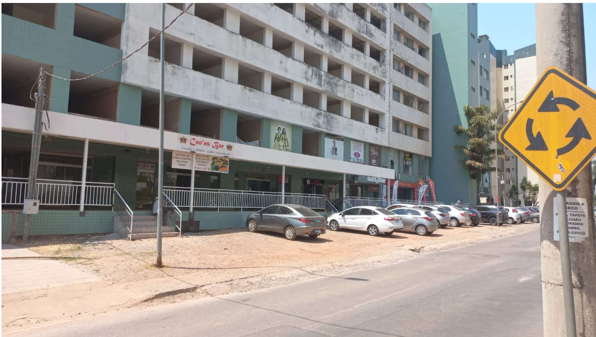
Figura 17: Passeio irregular, desnivelado e descontínuo, sem caracterização adequada
