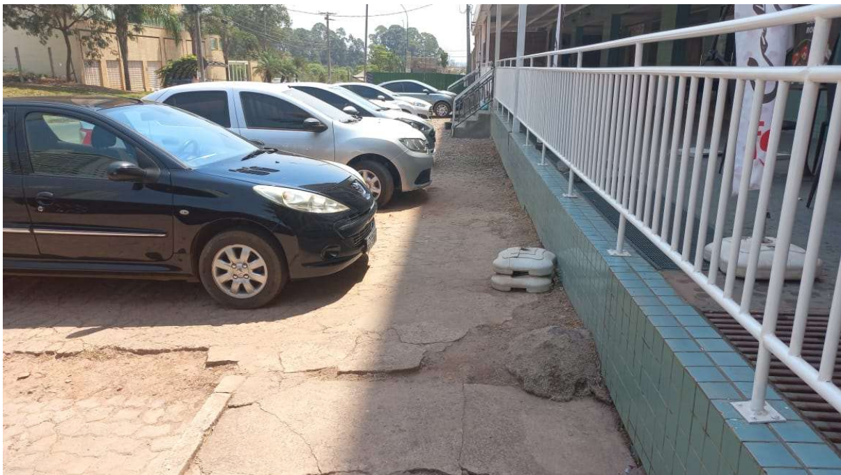
Figura 15: Calçada irregular, desnivelada e descontínua, com veículos sobre o passeio
