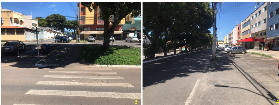
Figura 15 - Foto 3, sinalização desgastada. Foto 4, mobiliário urbano fora da faixa de serviço.
