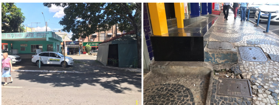
Figura 22 - Foto 1, faixa de pedestre desalinhada. Foto 2, desníveis nas calçadas e rampas improvisadas.
