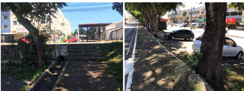
Figura 16 - Foto 5, desnível de acesso no canteiro central. Foto 6, calçadas quebradas por raízes de árvore.
