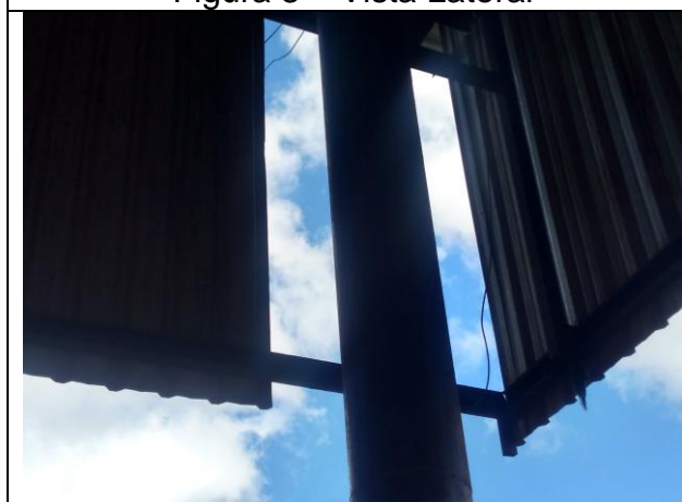
Figura 5 – Fiação elétrica exposta
