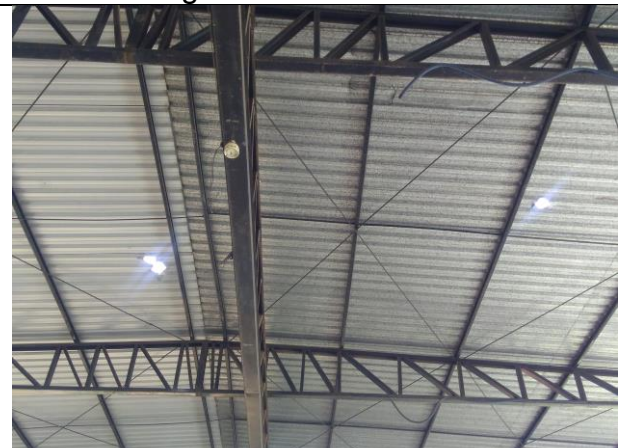
Figura 4 – Danos na cobertura
