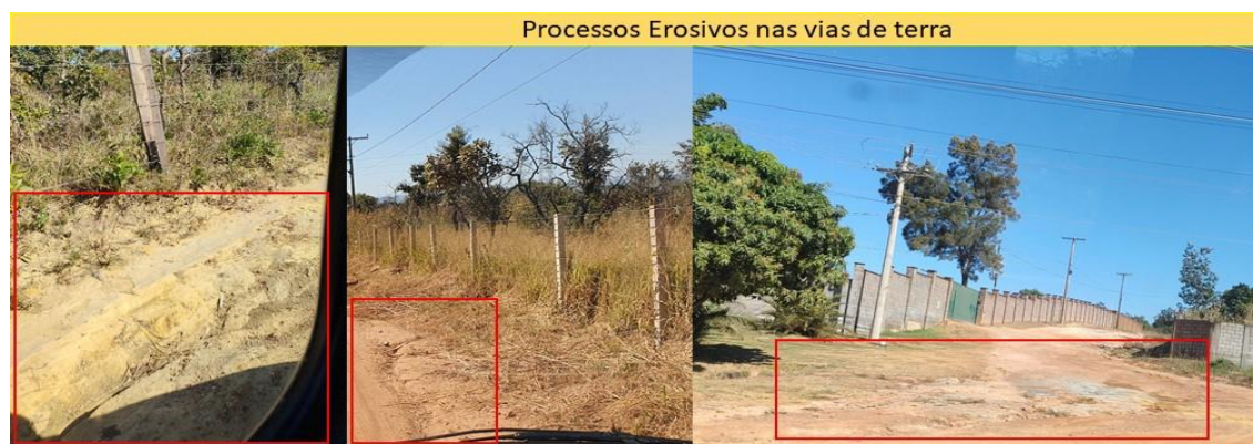
Figura 31: Processos hidroerosivos nas vias não pavimentadas, causados pela ação da chuva e do escoamento superficial
