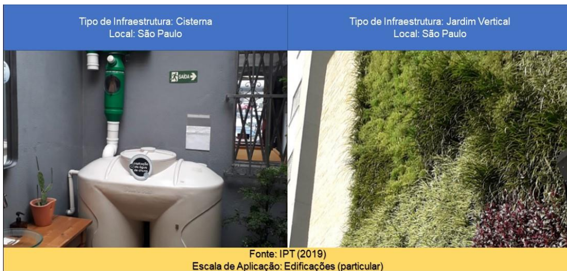
Figura 82: Exemplo de infraestrutura verde de drenagem urbana na escala da fonte
